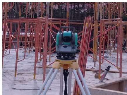
Gambar 2 19 Total Station (Sumber : dokumentasi Lapangan 2024)
