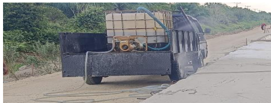
GAMBAR 3. 5Water Tank (Sumber) : Dokumen Lapangan, 2024
