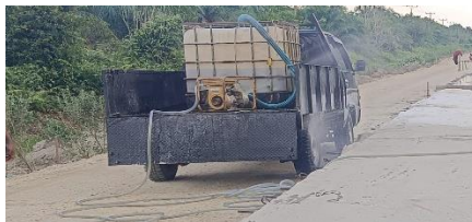
GAMBAR 4. 4 Water Tank (Sumber) : Dokumen Lapangan, 2024
