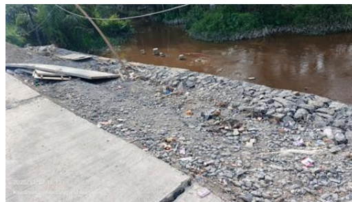
Gambar 3.65 Krsakan pada beronjong Sumber: Dokumentasi Lapangan
