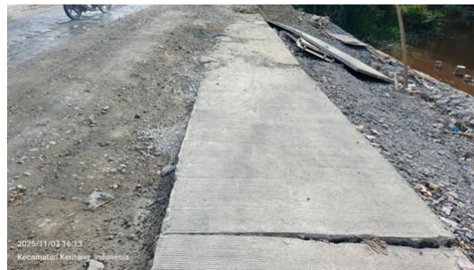
Gambar 3.64 Kerusakan pada trotoar Sumber: Dokumentasi Lapangan
