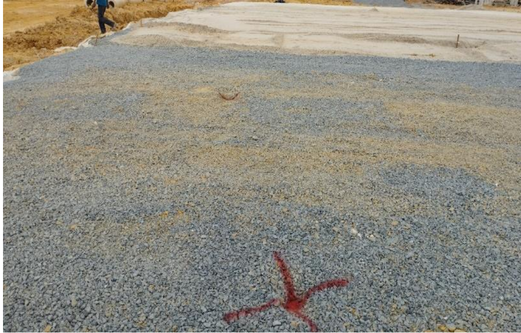
Gambar 3.113 Area split yang kurang dari 10 cm (Sumber: Dokumentasi Pribadi)
