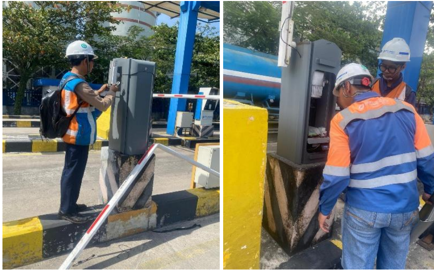
Gambar 3. 6 Pemasangan Palang Parkir Otomatis(Barrier Gate)
