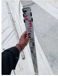
Gambar 3. 18 Rambu Ukur (Sumber: Dokumentasi Kerja Praktek, 2024)
