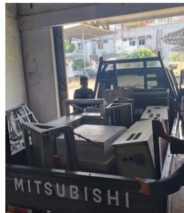
Gambar 3. 8 Penurunan Baterai Site
