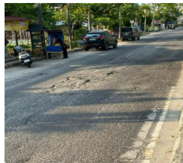
Gambar 1. 2 penampakan jalan Patimura setelah terendam banjir (Sumber: Dokumentasi Pribadi, 2026)
