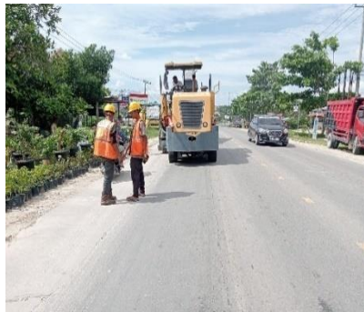
Gambar 3. 65 Survei dan Identifikasi Kerusakan (Sumber Dokumentasi Lapangan 2025)
