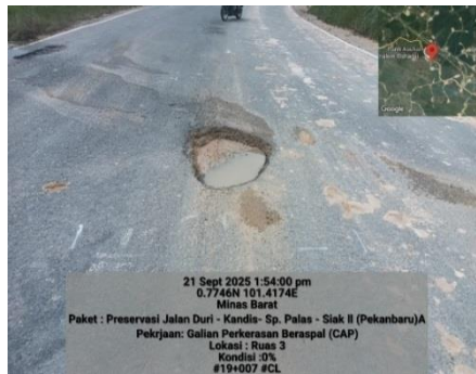
Gambar 3. 54 Kerusakan Lubang Pada Jalan (Sumber Dokumentasi Lapangan 2025)
