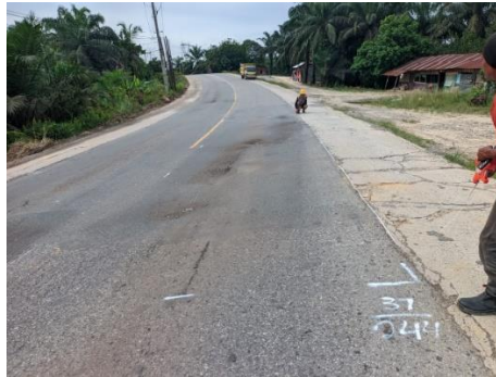
Gambar 3. 9 Kerusakan Pada Jalan (Sumber Dokumentasi Lapangan 2025)
