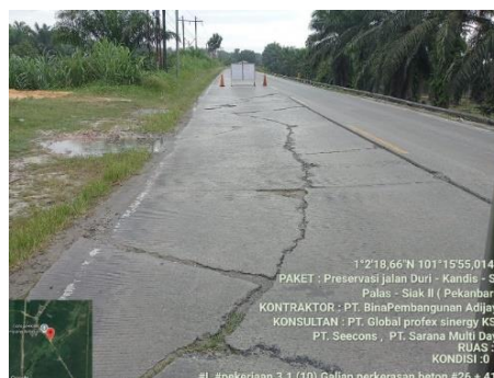
Gambar 3. 28 Identifikasi Kerusakan Beton (Sumber Dokumentasi Lapangan 2025)
