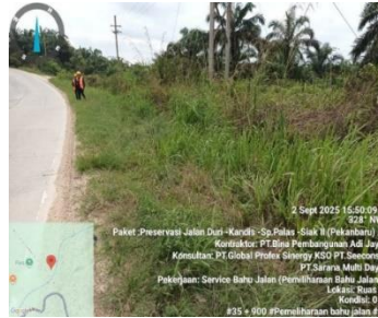
Gambar 3. 4 Kondisi Bahu Jalan yang Semak (Sumber Dokumentasi Lapangan 2025)
