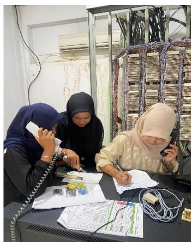
Gambar 3. 1 Instalasi Jaringan Intranet Pada Perangkat Main Distribution Frame
