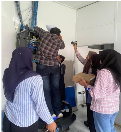
Gambar 3. 5 Perawatan dan Perapihan Horizontal cabling di Rak Server IT
