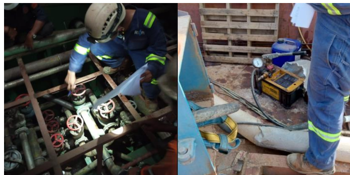
Gambar 3. 50 Proses Inspeksi Class pada Pipa
