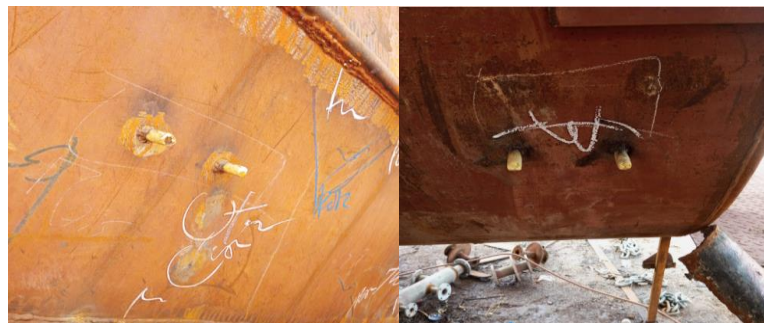
Gambar 4. 5 Kedudukan Zinc Anode
