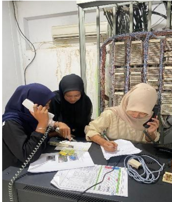
Gambar 3. 1 Instalasi Jaringan Intranet Pada Perangkat Main Distribution Frame
