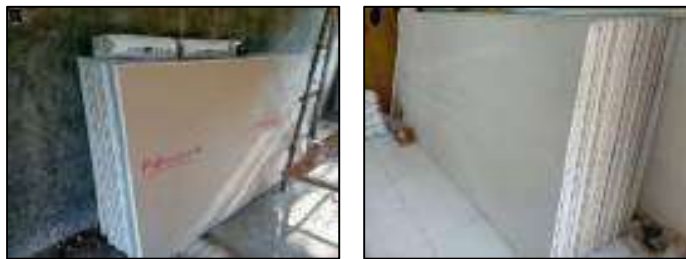
Gambar 3.89 Plafond gypsum board FUJI (Sumber : Dokumentasi KP, 2025)
