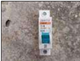
Gambar 3.108 MCB 1 phase (Sumber : Dokumentasi KP, 2025)
