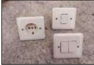
Gambar 3.107 Saklar dan stop kontak (Sumber : Dokumentasi KP, 2025)
