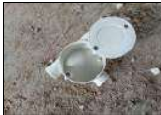
Gambar 3.106 Terminal blok kabel / T dust cabang 3 (Sumber : Dokumentasi KP, 2025)
