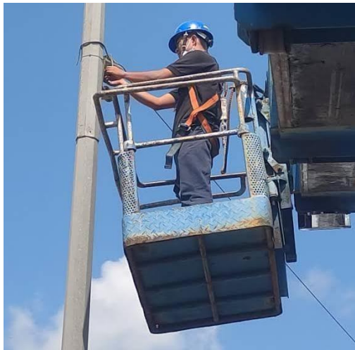
Gambar 3. 1 Pemeliharaan dan Perbaikan Sistem CCTV
