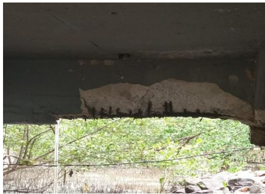
Gambar 1. 1 Kerusakan Konstruksi Jembatan (Sumber: Jembatan Bengkalis)
