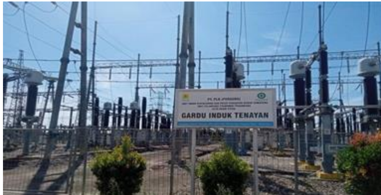
Gambar 1. 2 Gardu Induk Tenayan
