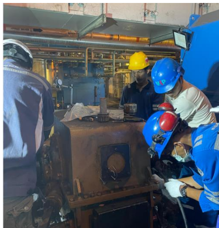
Gambar 2. 15 pemasangan sensor pada sistem Boiler Feed Pump (BFP)
