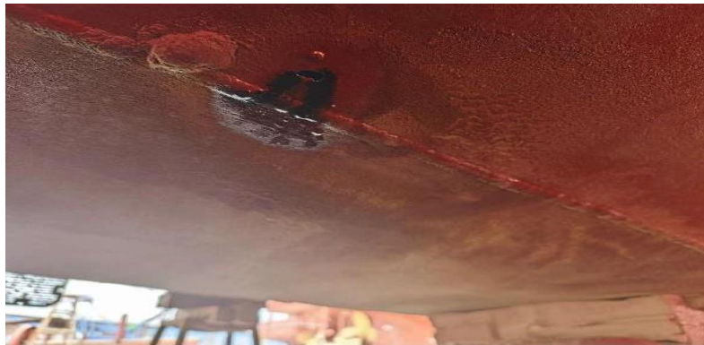
Gambar 4.11 Temuan Baru Pelat Bottom Yang Bolong
