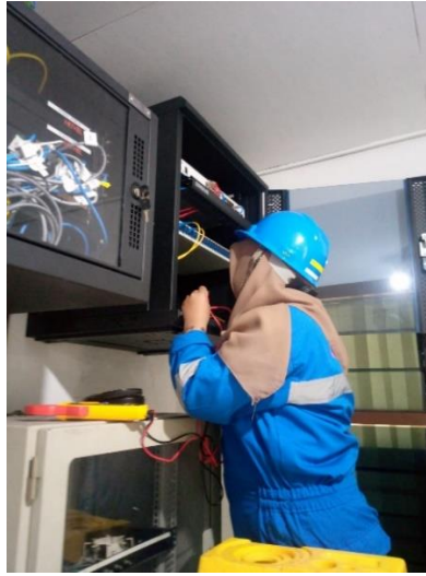
Gambar 3.1 Pemeliharaan Perangkat Jaringan di Area Kerja PT Pertamina RU II Sei Pakning
