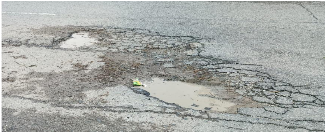
Gambar 1. 1 Kerusakan Jalan Akibat Genangan Air (Sumber : Dokumentasi Pribadi, 2024)
