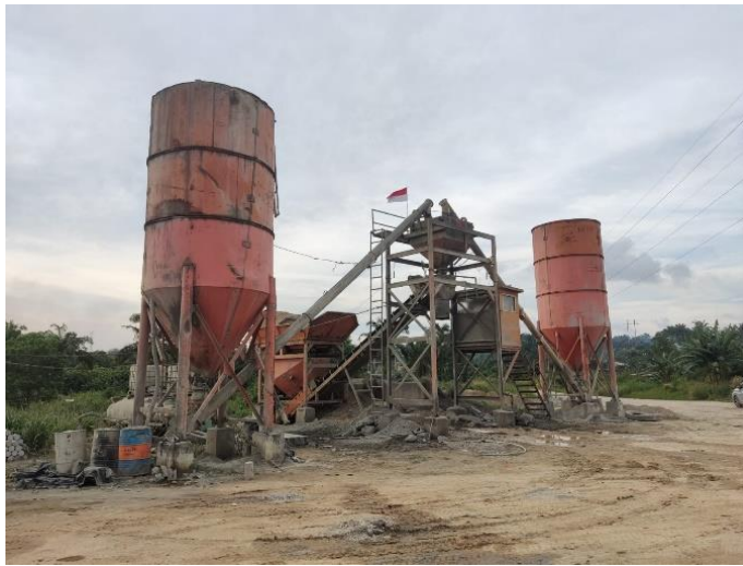
Gambar 3.8 (Batching Plan) Sumber : Dokumentasi Lapangan, 2024
