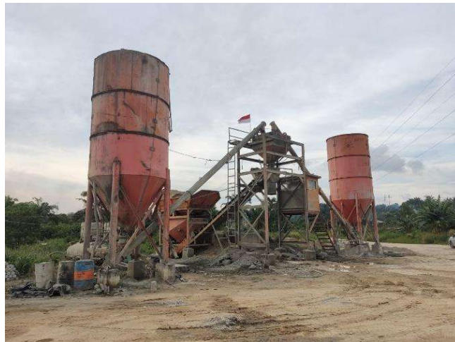
Gambar 3. 9 Batching Plant Sumber : Dokumentasi Lapangan
