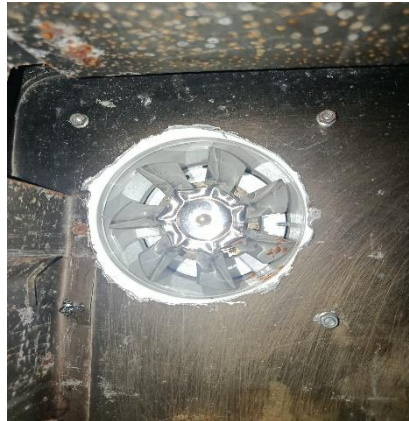
Gambar 4. 2 Exhaust fan (Sumber: Dokumentasi pribadi, 2025)
