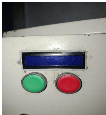
Gambar 4. 8 Push button ON/OFF (sumber: Dokumentasi pribadi, 2025)
