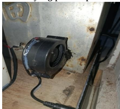
Gambar 4. 3 Blower fan (Sumber: Dokumentasi pribadi, 2025)
