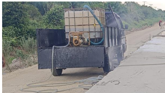
Gambar 3. 5 Water tank (sumber) dokumentasi lapangan
