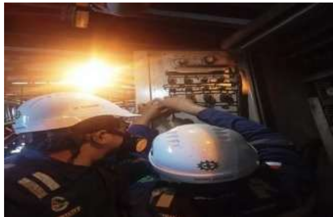
Gambar 3. 21 inspeksi penormalan magnetic separator C03
