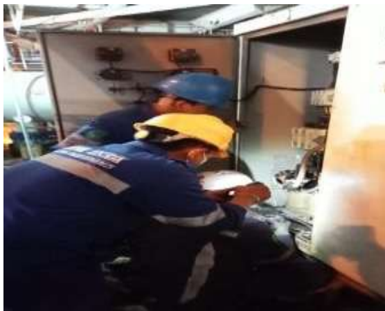
Gambar 3. 35 inspeksi hotspot panel motor (OCCWP)
