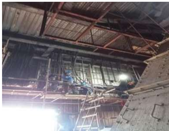
Gambar 3. 80 inspeksi kabel terbakar
