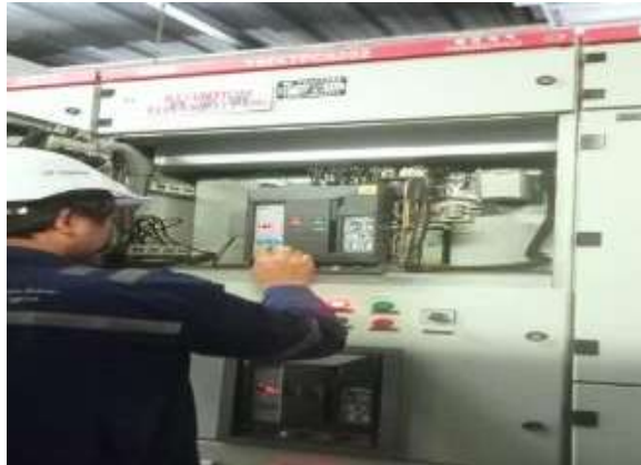
Gambar 3. 32 inspeksi breaker C03 A area CHCB
