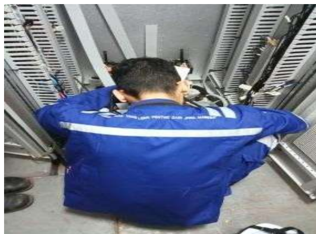
Gambar 3. 17 penormalan alarm proteksi AVR
