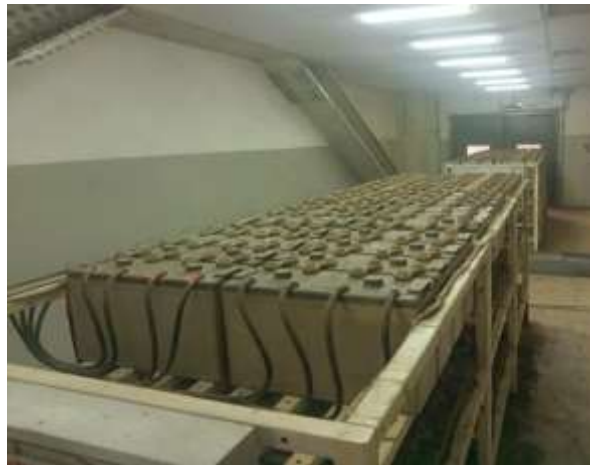
Gambar 4. 8 Baterai Eksitasi PLTU Tenayan
