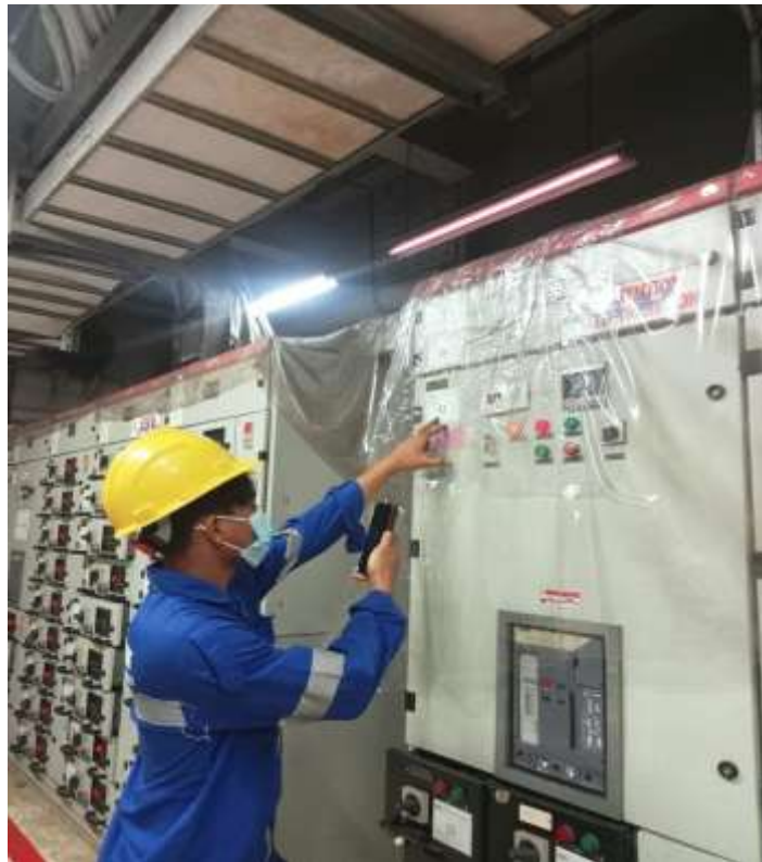
Gambar 3. 104 Gambar pendataan panel 400 Volt
