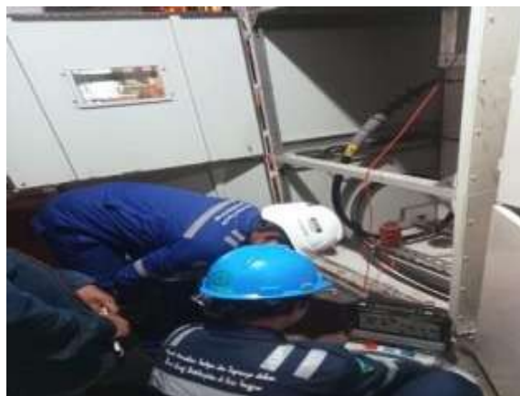
Gambar 3. 58 megger trafo unit 1
