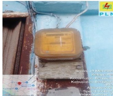
Gambar 3. 35 Kwh meter tua. (Sumber: Dokumentasi, 2025)
