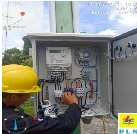
Gambar 3. 16 pemeriksaan Kwh meter pelanggan. (Sumber: Dokumentasi, 2025)
