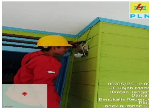
Gambar 3. 31 pemeriksaan Kwh meter pelanggan. (Sumber: Dokumentasi, 2025)
