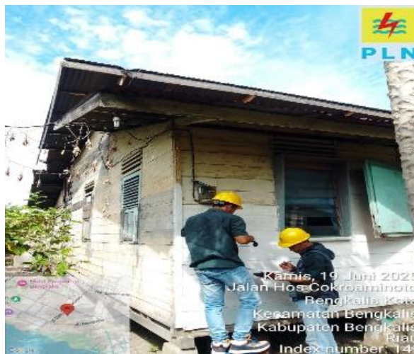
Gambar 3. 51 pemeriksaan Kwh meter pelanggan. (Sumber: Dokumentasi, 2025)
