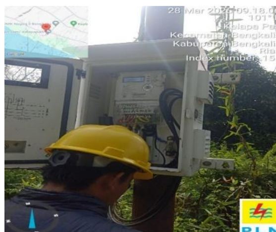
Gambar 3. 23 pemeriksaan Kwh meter pelanggan. (Sumber: Dokumentasi, 2025)
