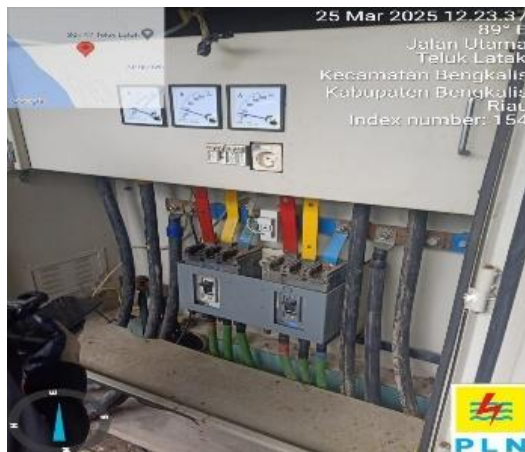
Gambar 3. 22 pengukuran beban. (Sumber: Dokumentasi, 2025)
