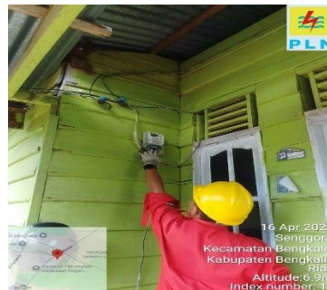
Gambar 3. 27 pemeriksaan Kwh meter pelanggan. (Sumber: Dokumentasi,2025)
