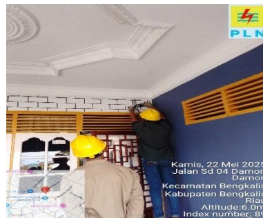
Gambar 3. 38 pemeriksaan Kwh meter pelanggan. (Sumber: Dokumentasi, 2025)
