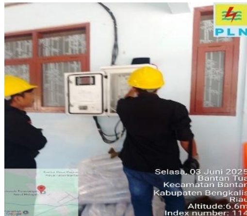
Gambar 3. 43 pemeriksaan Kwh meter pelanggan. (Sumber: Dokumentasi, 2025)
