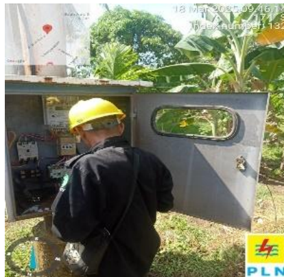
Gambar 3. 20 pemeriksaan Kwh meter pelanggan (Sumber: Dokumentasi, 2025)
