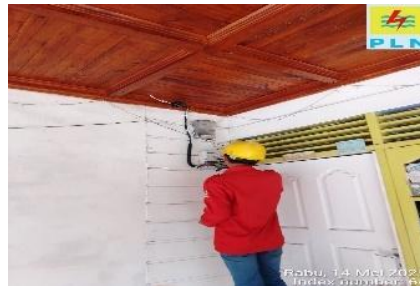
Gambar 3. 34 pemeriksaan Kwh meter pelanggan. (Sumber: Dokumentasi,2025)
