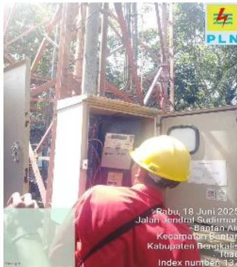
Gambar 3. 50 pemeriksaan Kwh meter pelanggan. (Sumber: Dokumentasi, 2025)
