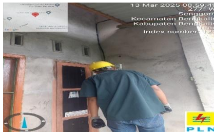
Gambar 3. 18 pemeriksaan Kwh meter pelanggan. (Sumber: Dokumentasi, 2025)
