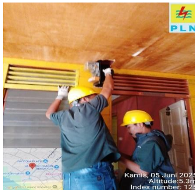
Gambar 3. 45 pemeriksaan Kwh meter pelanggan. (Sumber: Dokumentasi,2025)
