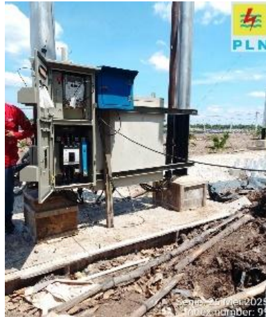
Gambar 3. 40 pemeriksaan Kwh meter pelanggan. (Sumber: Dokumentasi, 2025)
