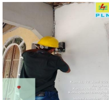
Gambar 3. 47 pemeriksaan Kwh meter pelanggan. (Sumber: Dokumentasi, 2025)
