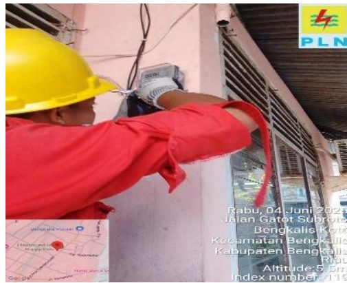
Gambar 3. 44 pemeriksaan Kwh meter pelanggan. (Sumber: Dokumentasi, 2025)
