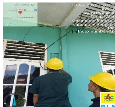
Gambar 3. 25 pemeriksaan Kwh meter pelanggan. (Sumber: Dokumentasi,2025)
