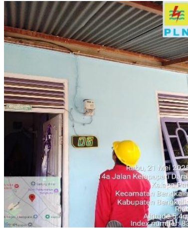
Gambar 3. 37 pemeriksaan Kwh meter pelanggan. (Sumber: Dokumentasi, 2025)
