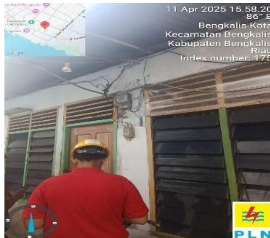
Gambar 3. 26 pemeriksaan Kwh meter pelanggan. (Sumber: Dokumentasi,2025)
