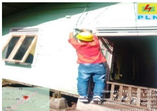
Gambar 3. 49 pemeriksaan Kwh meter pelanggan. (Sumber: Dokumentasi, 2025)
