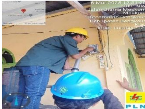
Gambar 3. 15 pemeriksaan Kwh meter pelanggan. (Sumber:Dokumentasi,2025)
