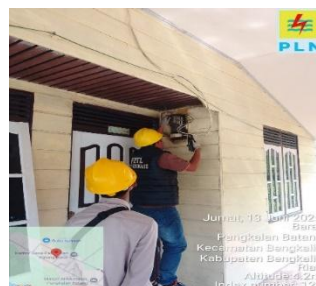
Gambar 3. 48 pemeriksaan Kwh meter pelanggan. (Sumber: Dokumentasi, 2025)
