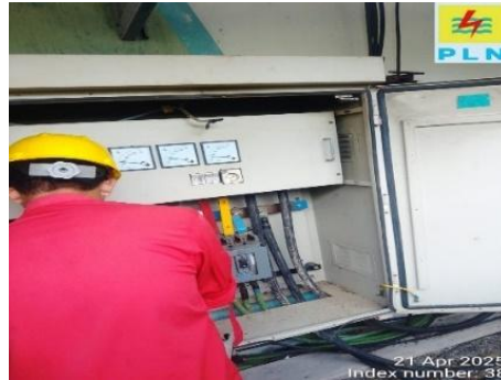
Gambar 3. 28 pengukuran beban. (Sumber: Dokumentasi, 2025)
