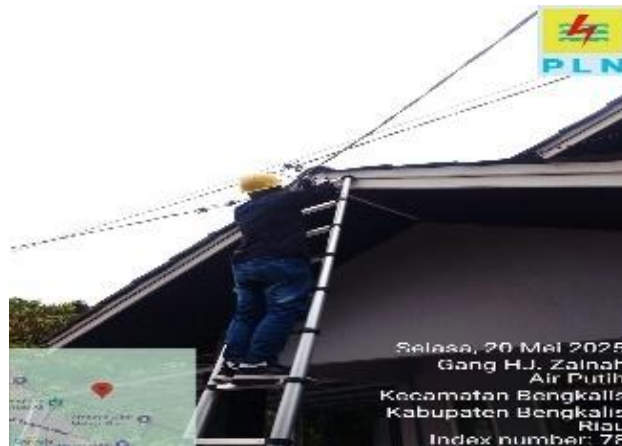
Gambar 3. 36 pengecekan arus bocor. (Sumber: Dokumentasi, 2025)
