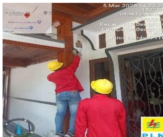
Gambar 3. 14 pemeriksaan Kwh meter pelanggan. (Sumber: Dokumentasi,2025)
