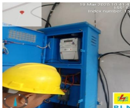
Gambar 3. 21 pemeriksaan Kwh meter pelanggan. (Sumber: Dokumentasi, 2025)
