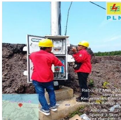
Gambar 3. 33 pemeriksaan Kwh meter pelanggan. (Sumber: Dokumentasi, 2025)
