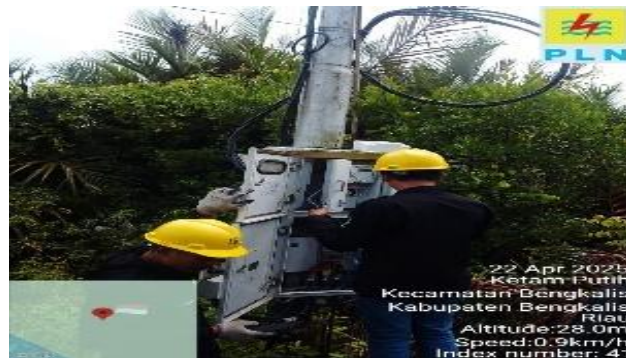
Gambar 3. 29 pemeriksaan Kwh meter pelanggan. (Sumber: Dokumentasi, 2025)
