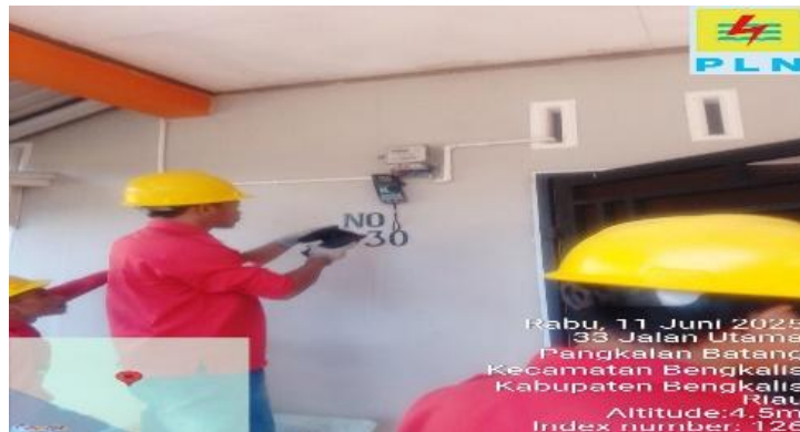
Gambar 3. 46 pemeriksaan Kwh meter pelanggan. (Sumber: Dokumentasi, 2025)
