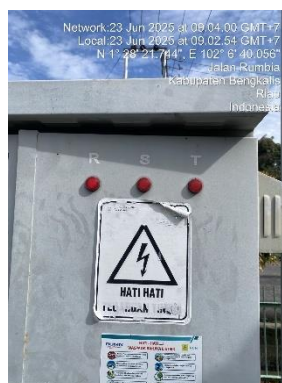
Gambar 3.3.9 PHB-TR (Panel Hubung Bagi-Tegangan Rendah)
