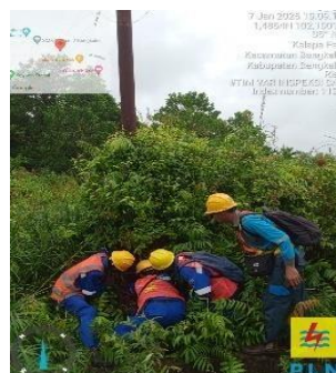
Gambar 2.5 Pengecekan pada tiang keropos
