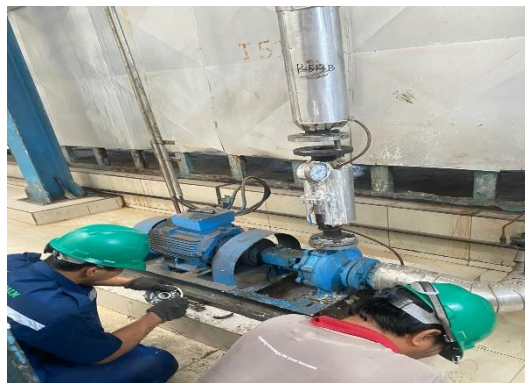
Gambar 4. 2 Pompa Sentrifugal Sumber: Dokumen Pribadi
