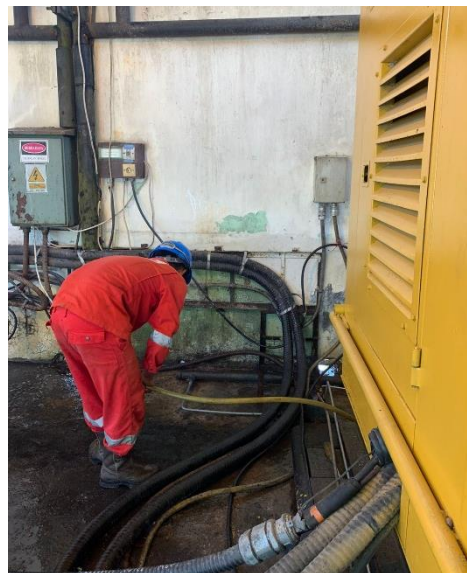
Lampiran 4 Cleaning area genset Catervilar Sumber : Dokumentasi lapangan
