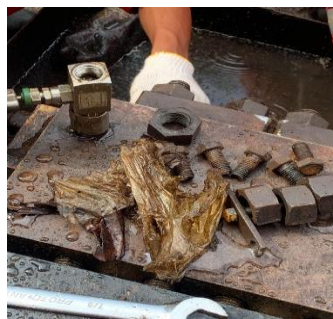
Gambar 4. 5 Penemuan material asing (plastik dan dedaunan) di dalam pompa Sumber : Dokumentasi Lapangan
