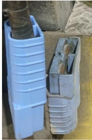
Gambar 4.1. 7 Terminal Box Sumber: Dokumen Pribadi
