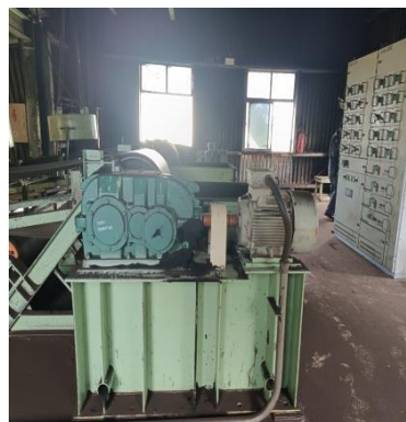
Gambar 4. 5 Motor Penggerak (Sumber : Dokumentasi PT. Power Plant )
