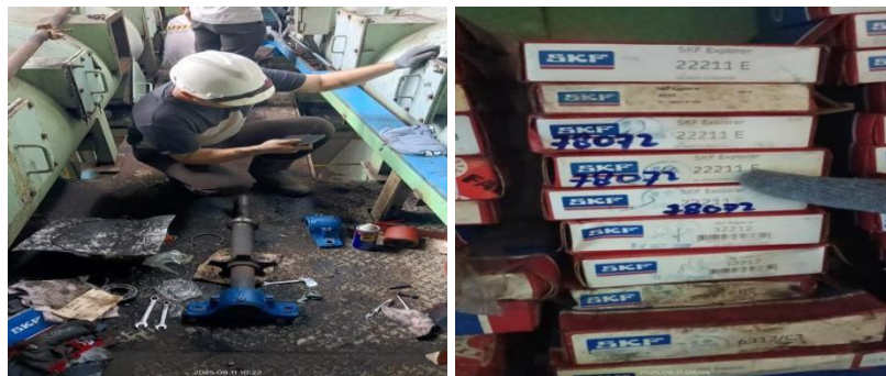
Gambar 3. 24 Kegiatan Senin 11 Agustus 2025 (Sumber : Dokumentasi PT. Power Plant)
