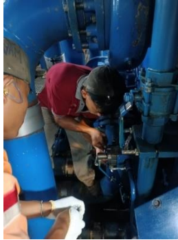
Gambar 3.49 pilot pump (sumber : dokumentasi penulis. 2025)
