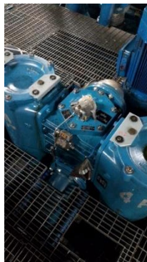
Gambar 3.50 filter booster (sumber : dokumentasi penulis. 2025)
