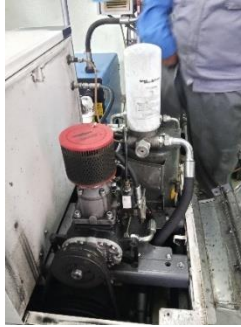
Gambar 3. 33 Compressor Instruktur air
