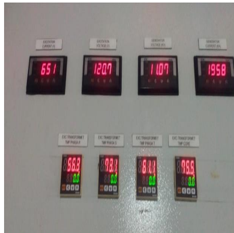
Gambar 3.53 Pengecekan pada panel mcc
