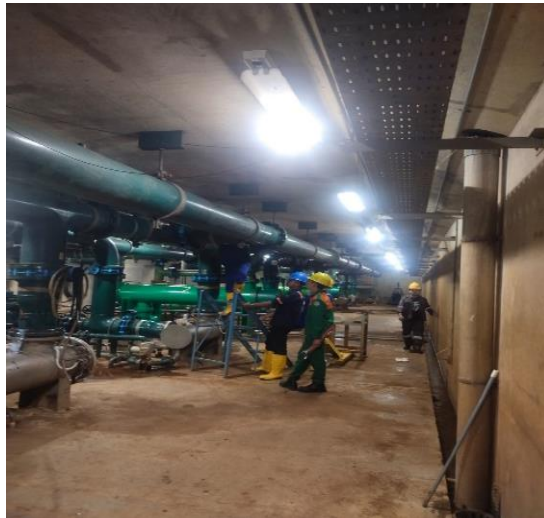
Gambar 3.94 Pencucian pada HE(Heat exchanger)
