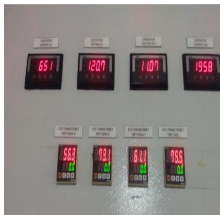
Gambar 3.68 Pengecekan nilai pada panel mcc
