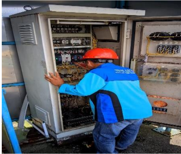
Gambar 3. 27 Pengecekan pada panel sel (Sumber: dokemntasi penulis 2025)
