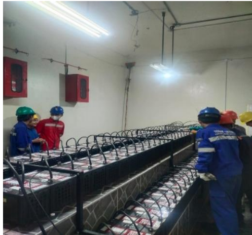
Gambar 3.97 Ruang baterai 110 vdc
