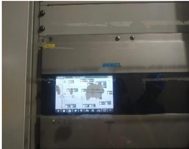
Gambar 3.40 Pengecekan nilai di plc
