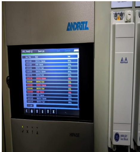
Gambar 3.18 Perbaikan proteksi terkena sambaran petir
