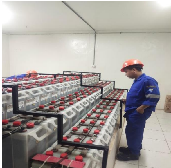
Gambar 3.47 Pengecekan batrai kering (Sumber: dokemntasi penulis 2025)
