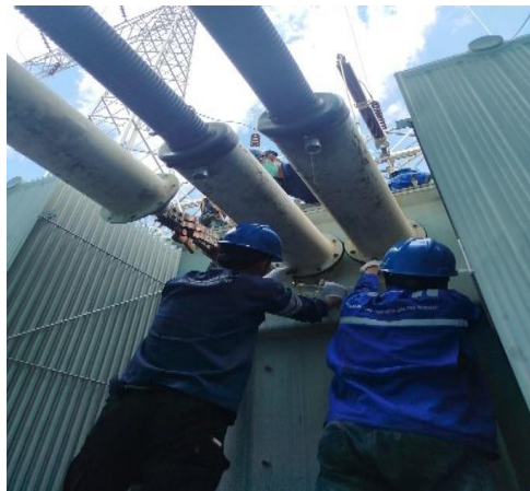
Gambar 3.80 Pembukaan di sisi trafo
