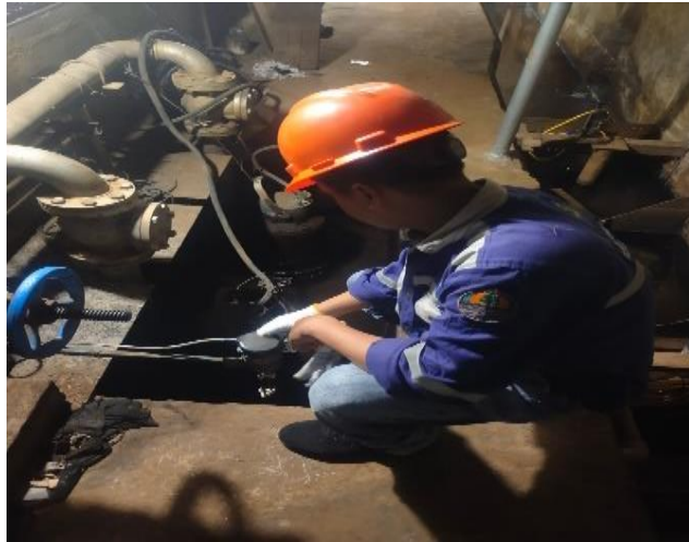
Gambar 3.49 Pengecekan pada diode dam galery
