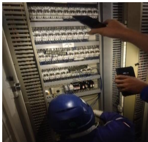
Gambar 3.39 Pengecekan panel mcc (Sumber: dokemntasi penulis 2025)
