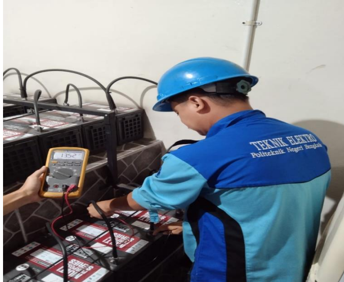
Gambar 3.71 Pengecekan tegangan batrai 220 AC
