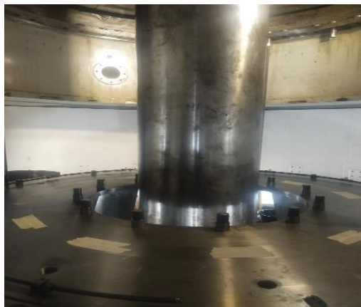
Gambar 3.88 Pengecekan di ruangan comben bering
