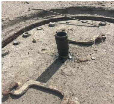
Gambar 4.9 Pipa penetrasi dari pipa udara
