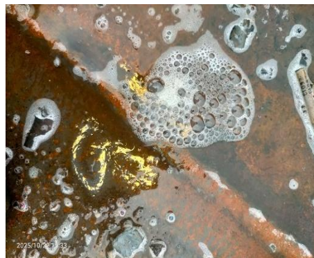
Gambar 4. 14 Area yang bocor
