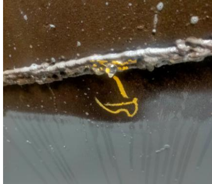
Gambar 4. 15 Penandaan area yang bocor
