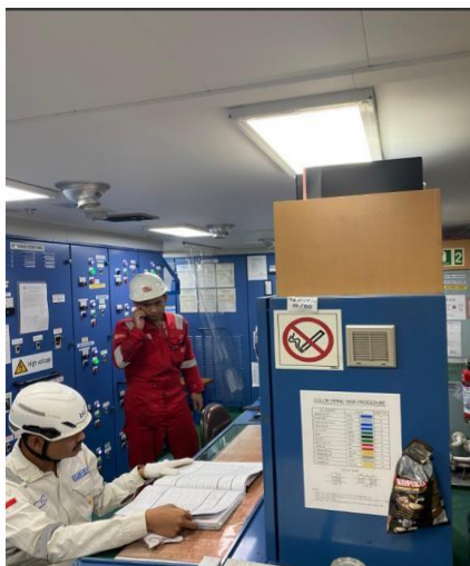
Gambar 3.1 Melakukan Pengecekan Pada Engine Control Room
