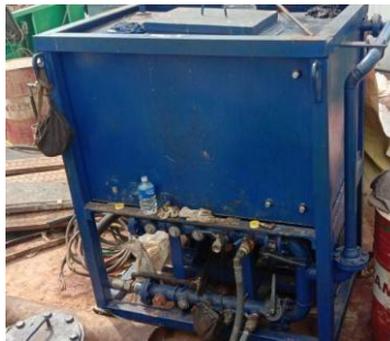
Gambar 4. 7 Pompa unit hidrolik
