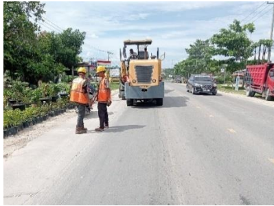
Gambar 3. 61 Survei dan Identifikasi Kerusakan (Sumber Dokumentasi Lapangan 2025)
