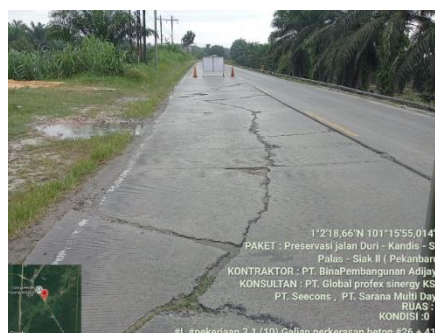
Gambar 3. 28 Identifikasi Kerusakan Beton (Sumber Dokumentasi Lapangan 2025)
