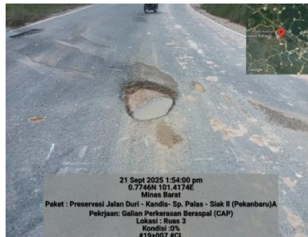
Gambar 3. 50 Kerusakan Lubang Pada Jalan (Sumber Dokumentasi Lapangan 2025)
