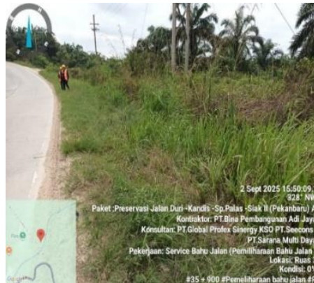
Gambar 3. 4 Kondisi Bahu Jalan yang Semak (Sumber Dokumentasi Lapangan 2025)
