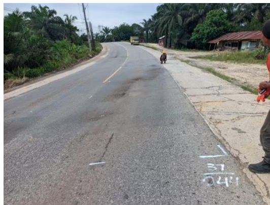
Gambar 3. 9 Kerusakan Pada Jalan (Sumber Dokumentasi Lapangan 2025)
