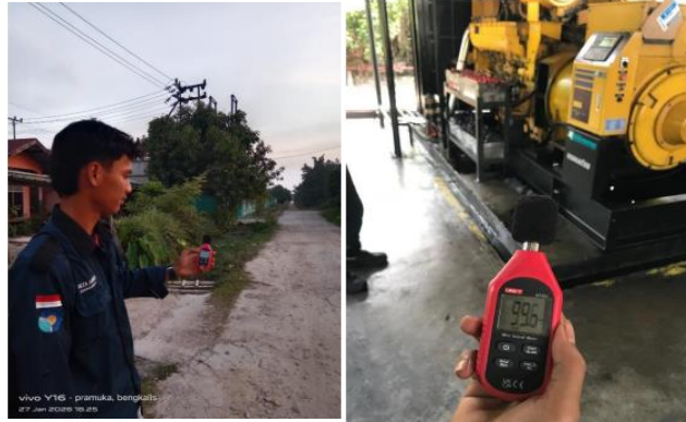
Gambar 1.2. Pengukuran Suara Genset (Sumber: Dokumentasi Penelitian, 2026)
