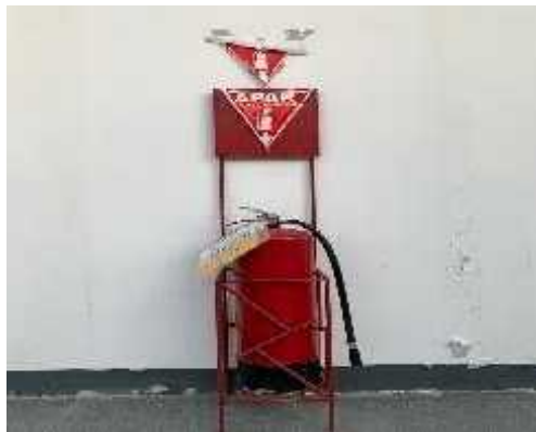
Gambar 2. 74: Inspeksi Alat Pemadam Api Ringan (APAR)
