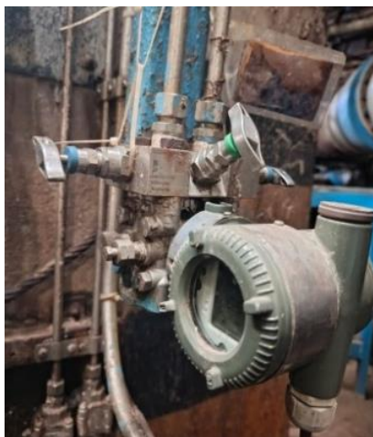
Gambar 3.5 Differential Pressure Transmitter untuk orifice plate Sumber: (Dokumentasi, 2026)
