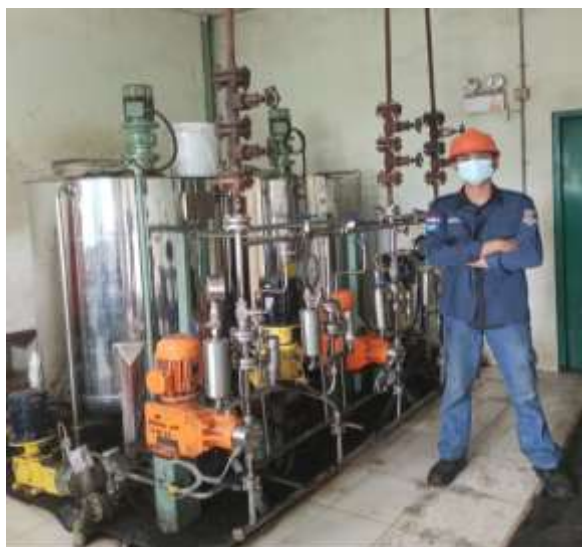
Gambar 3. 1 Chemical Dosing Room (Sumber :Dokumentasi Penulis)
