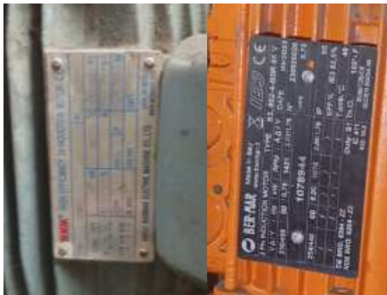
Gambar 3. 6 Nameplate kedua Pompa (Sumber : Dokumentasi Penulis)
