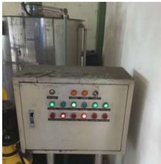
Gambar 3. 5 Control Panel Chemical Room (Sumber : Dokumentasi Penulis)
