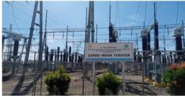
Gambar 1. 2 Gardu Induk Tenayan (Sumber: PT PLN Nusantara Power UP Tenayan, 2024)
