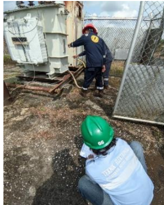
Gambar 2. 15 pengambilan data transformator Sumber : (Dokumentasi)
