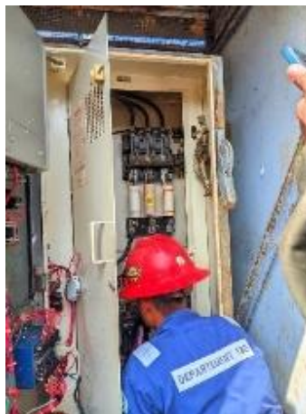
Gambar 2. 5 switchboard Sumber : (Dokumentasi)
