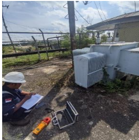
Gambar 2. 11 inspection grounding dan thermographic Sumber : (Dokumentasi)
