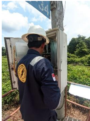
Gambar 2. 2 Recloser Sumber : (Dokumentasi)
