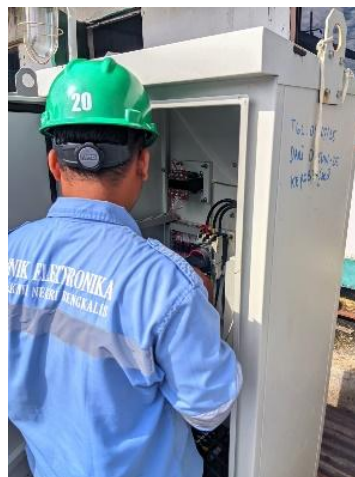
Gambar 2. 7 VSD ( Variable Speed Drive ) Sumber : (Dokumentasi)
