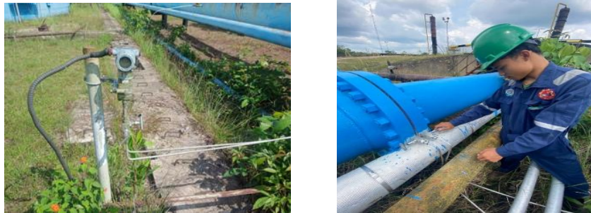
Gambar 3. 5 Root valve dan Differential Pressure Flow Transmitter Sumber : (Dokumentasi)
