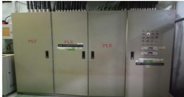
Gambar 3. 8 Marshalling Panel Sumber : (Dokumentasi)
