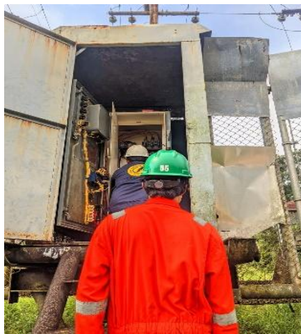
Gambar 2. 14 Switchboard Sumber : (Dokumentasi)
