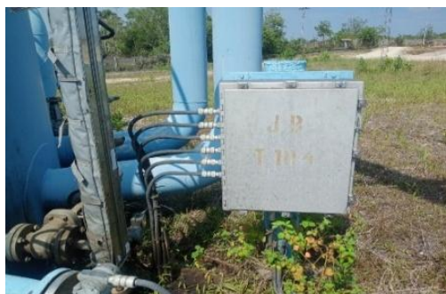
Gambar 3. 7 Field Junction Box Sumber : (Dokumentasi)
