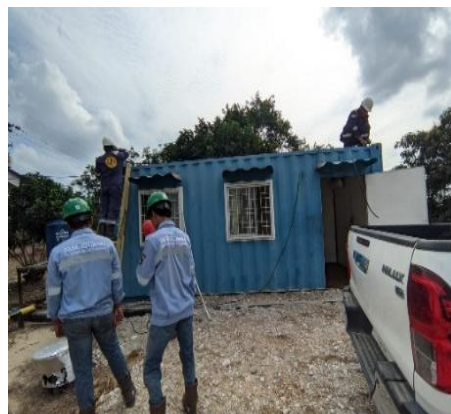
Gambar 2. 10 kabel lampu pada portacamp (GS) Sumber : (Dokumentasi)
