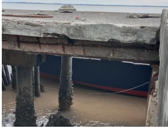
Gambar 1. 1 Kondisi Spalling pada Kawasan Pesisir (Sumber: Pelabuhan angkutan barang-kelenteng bengkalis)
