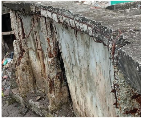
Gambar 1. 1 Kerusakan konstruksi jembatan
