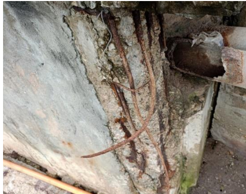
Gambar 1. 2 Spalling pada beton (Sumber: Jembatan bengkalis)
