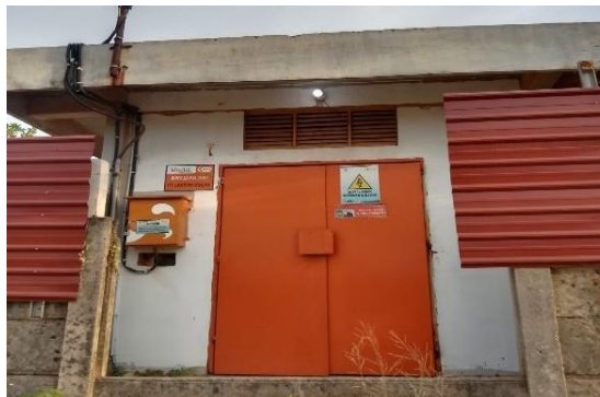
Gambar 2. 15 Gardu Listrik Sumber: PT LOI, (2025)
